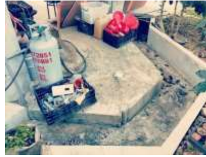
排水系統工程
